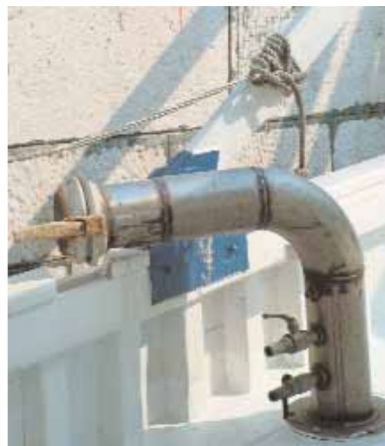
Inoks cijev sa zavarenim spojevima koji nisu pasivizirani
