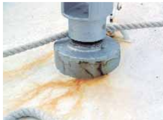
Premazivanje bojom ne zaustavlja proces korozije
